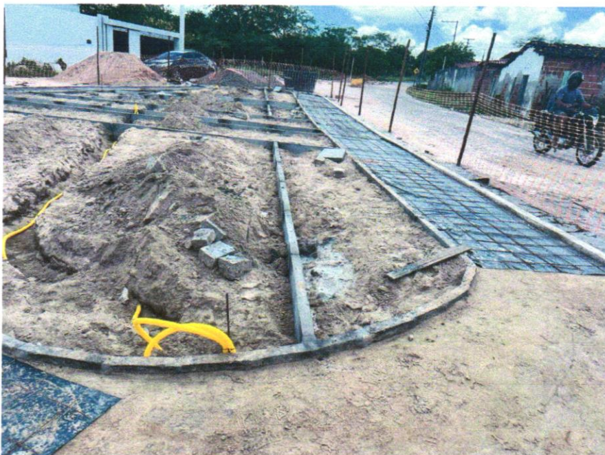
Foto 08 - ASSENTAMENTO DE GUIA (MEIO-FIO) EM TRECHO RETO, CONFECCIONADA EM CONCRETO PRÉ-FABRICADO, DIMENSÕES 80X08X08X25 CM (COMPRIMENTO X BASE INFERIOR X BASE SUPERIOR X ALTURA), PARA URBANIZAÇÃO INTERNA DE EMPREENDIMENTOS. AF_06/2016
