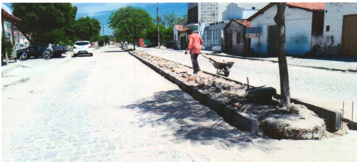
Foto 05 - ASSENTAMENTO DE GUIA (MEIO-FIO) EM TRECHO RETO, CONFECCIONADA EM CONCRETO PRÉ-FABRICADO, DIMENSÕES 100X15X13X20 CM (COMPRIMENTO X BASE INFERIOR X BASE SUPERIOR X ALTURA), PARA URBANIZAÇÃO INTERNA DE EMPREENDIMENTOS. AF_06/2016_P
