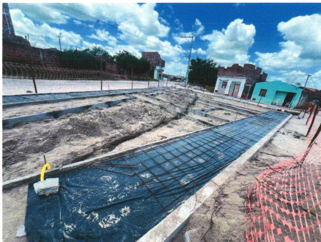
Foto 06 - ASSENTAMENTO DE GUIA (MEIO-FIO) EM TRECHO RETO, CONFECCIONADA EM CONCRETO PRÉ-FABRICADO, DIMENSÕES 100X15X13X20 CM (COMPRIMENTO X BASE INFERIOR X BASE SUPERIOR X ALTURA), PARA URBANIZAÇÃO INTERNA DE EMPREENDIMENTOS. AF_06/2016_P
