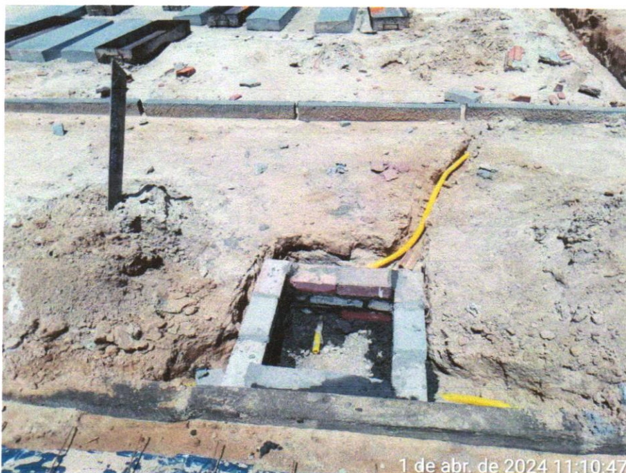
Foto 10 - CAIXA ENTERRADA ELÉTRICA RETANGULAR, EM ALVENARIA COM TIJOLOS CERÂMICOS MACIÇOS, FUNDO COM BRITA, DIMENSÕES INTERNAS: 0,3X0,3X0,3 M. AF_12/2020
